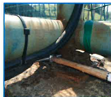
柱脚部のさび
