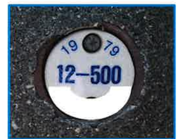
コンクリート柱の磁器製の銘板
