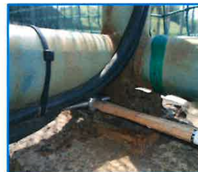
柱脚部のさび
