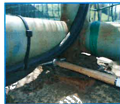
柱脚部のさび
